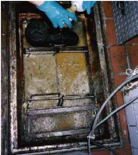
写真【A】 設置前 グリスト槽
