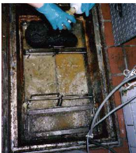
写真【A】 設置前 グリスト槽
